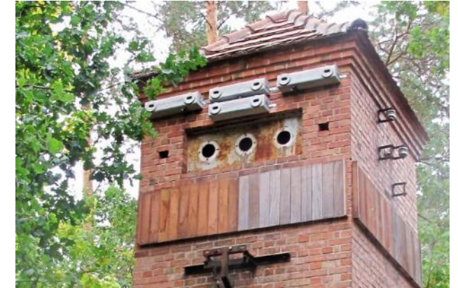
ARTENSCHUTZ – Trafohäuschen, Amphibienleiteinrichtungen, etc.
