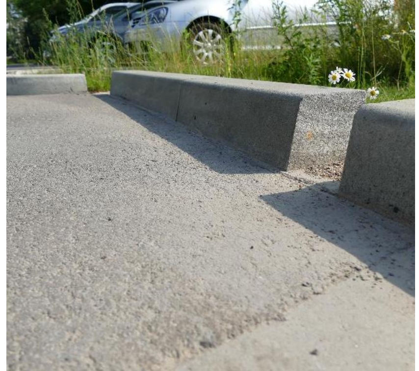
Abb. 4: Durchbrochene Bordsteinkanten, Cottbuser Straße Eberswalde
